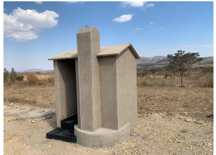
BVIP toilet in Nyanga
